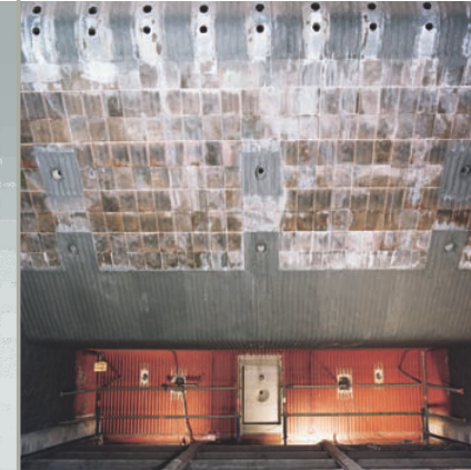
Feuerraumrückwand mit Einstiegstür
