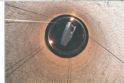
Innenansicht eines Kalkschachtofens
